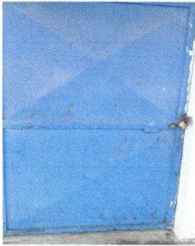
Foto1: Sustrucción de Chapa
