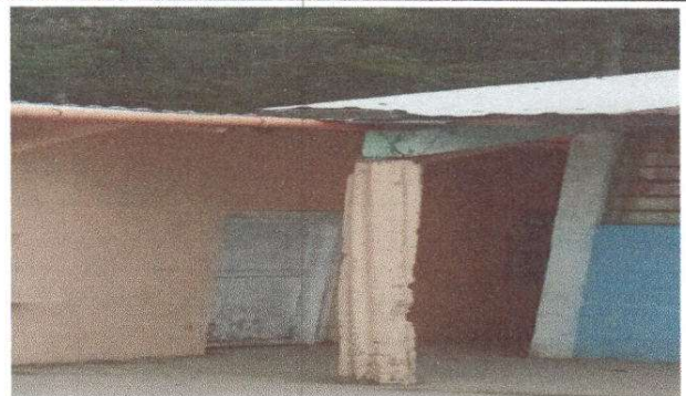
Foto 2: Sustrucción de Puerta
